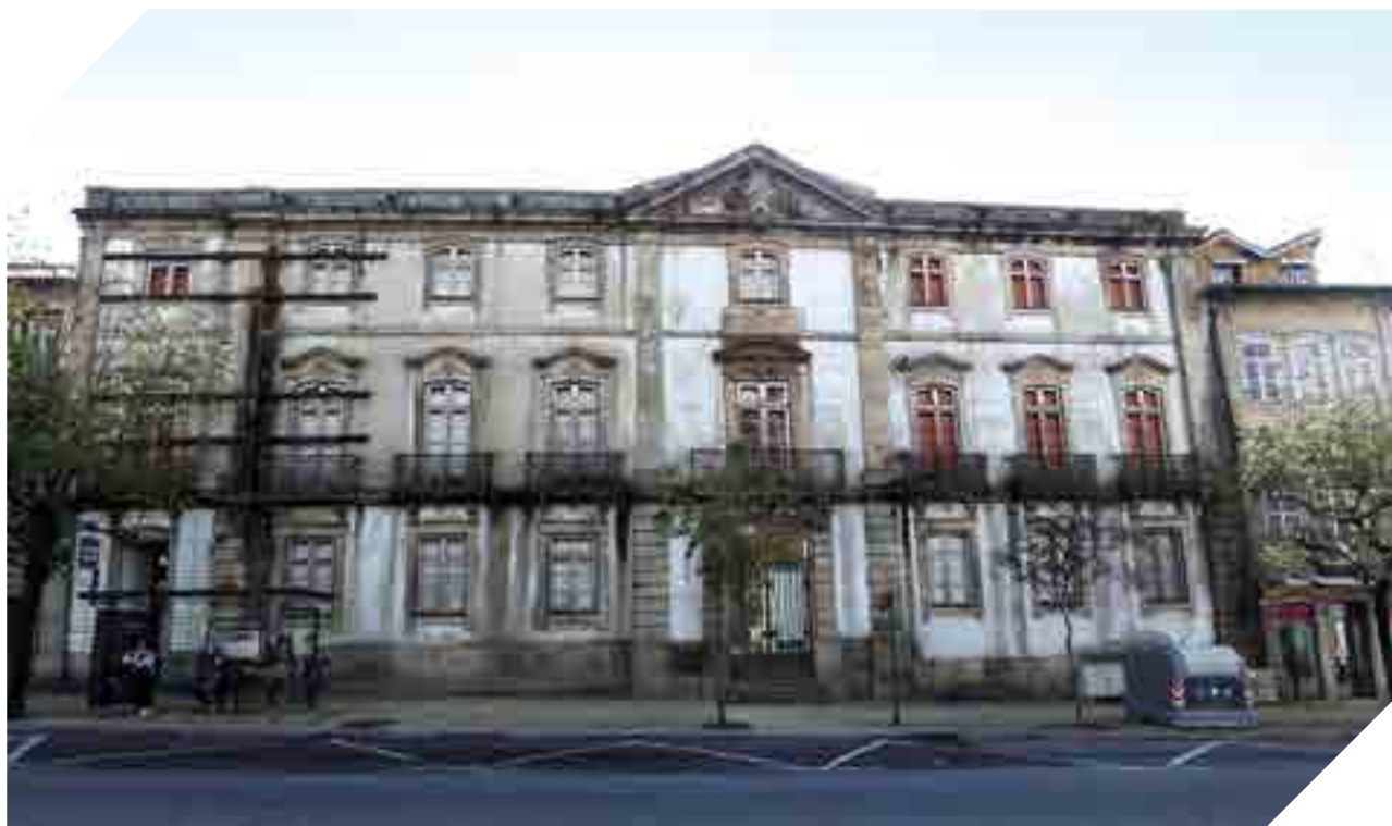
A muito degradada fachada do Palacete Vilhena Coutinho
